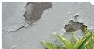
สีลอก่อน (Peeling)
